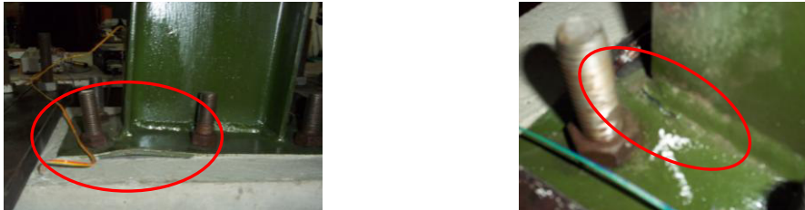
Gambar 5. Pelelehan Pelat, baut terelongasi dan retaknya las pada sambungan tipe NFC
